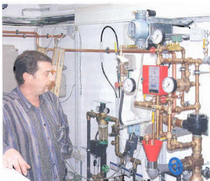
Sprinkler-Anlagentechnik im Hausanschlussraum: Vieles musste aus dem Industriebereich adaptiert werden, weil derzeit – auch aufgrund fehlender Regelwerke – die für ein Einfamilienhaus notwendigen Komponenten noch in der Entwicklungsphase stecken. (Fotos: Martin)
