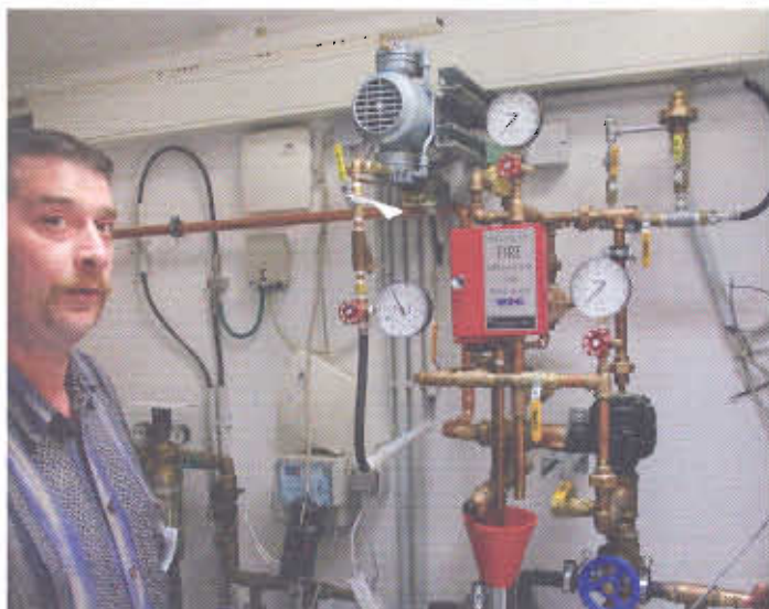
Die Testinstallation Frank Lange, Arasti GmbH, vor dem technischen Kern der Sprinkleranlage im Technikbereich des Hauses
