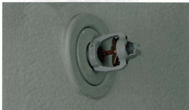
...oder frei sichtbare Sprinkler.
