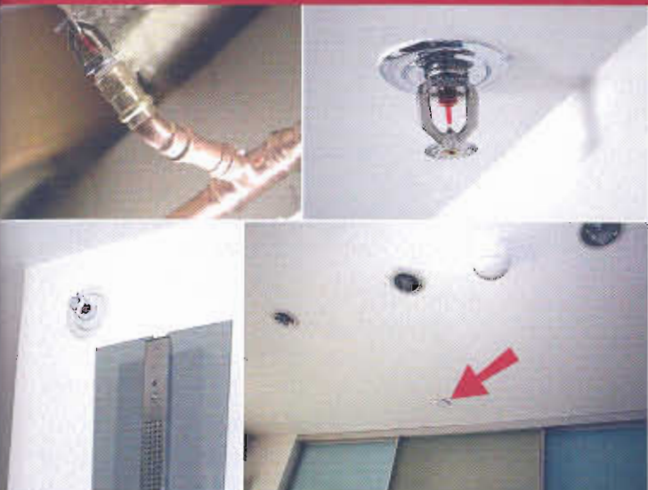
■ Von sichtbar bis unsichtbar. Die Produktvielfalt bietet auch für den privaten Bereich verschiedenste Varianten von Sprinklertypen. Zum Beispiel im rechten Bild: ein verdeckter Sprinkler.
