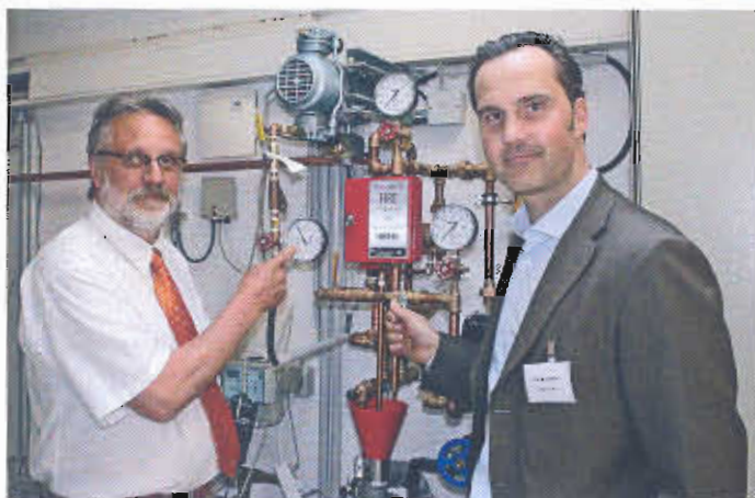
■ Alarmventilstation mit Kompressor. Heinrich Rausch (l.), Vorsitzender der Initiative Kupfer: „inHaus!“ wurde mit einer vorgesteuerten Versuchsanlage ausgestattet, einer Trockenanlage, die erst im Brandfall mit Wasser befüllt wird.“ Peter Aranowski, Geschäftsführer der Arastl GmbH: „Die Anlage macht zwar noch einen komplizierten Eindruck, sie wird aber später zur Serienreife in einer erheblich vereinfachten Variante gefertigt werden.“
