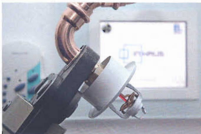
■ Durch den Einsatz von Kupfer in Kombination mit der Presstechnik gestaltete sich die Installation einfach und zeitsparend.
